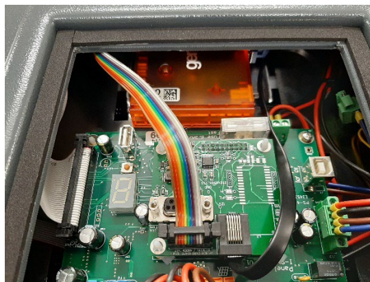
Abbildung 16: In den Kasten des I-SAFE eingesetztes Modem
