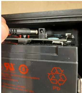
Figure 29 : connecteur DC - charge de la batterie
